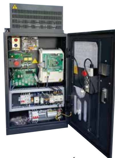
Tủ điện FUJI - THÁI LAN
